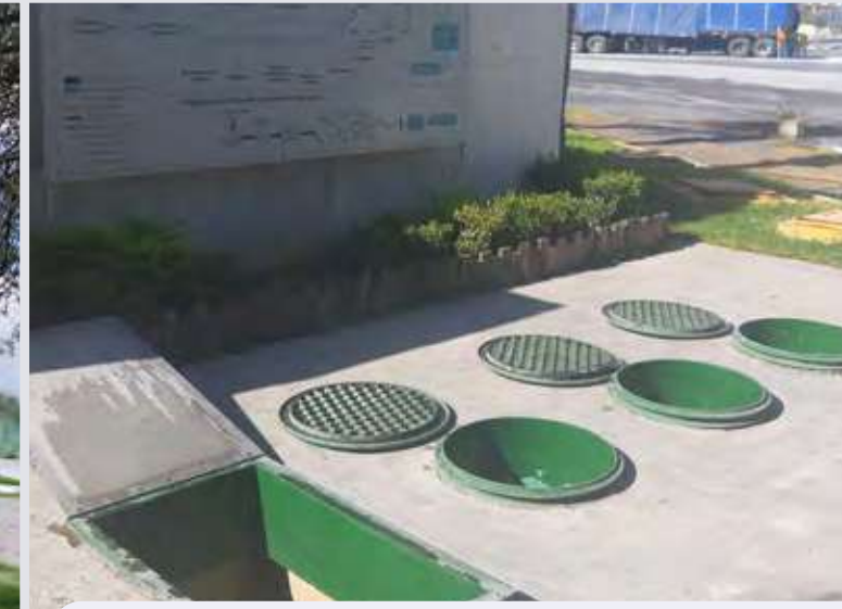
Sistema de tratamiento de agua residual, Planta Monterrey
